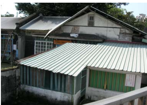
正立面、山牆及加建的違章建築
