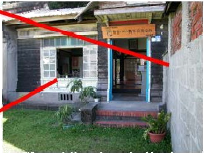
增建部分建議 拆除
