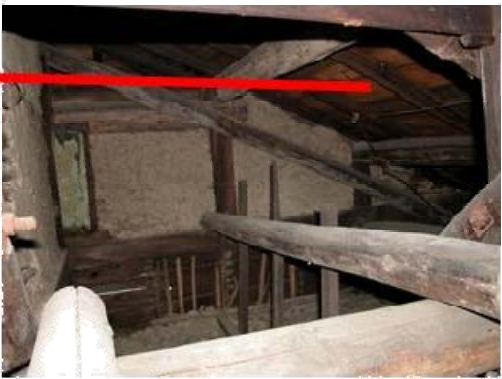
屋面板潮濕黴菌產生
