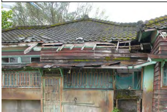
照片 4-38 左側檐口毀損嚴重
