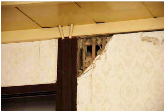
照片 7-3 編竹夾泥牆破損
