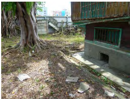
照片 4-4 榕樹根系危害建築
