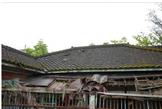
照片 4-26 屋瓦脫落
