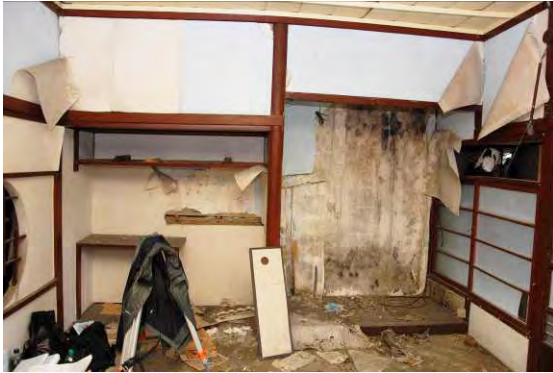
照片 4-30 牆面潮溼破損
