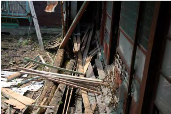
照片 7-1 木作地坪毀損嚴重
