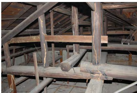
照片 4-27 屋架白蟻蛀蝕
