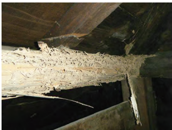
照片 4-13 屋架構件受白蟻危害嚴重
