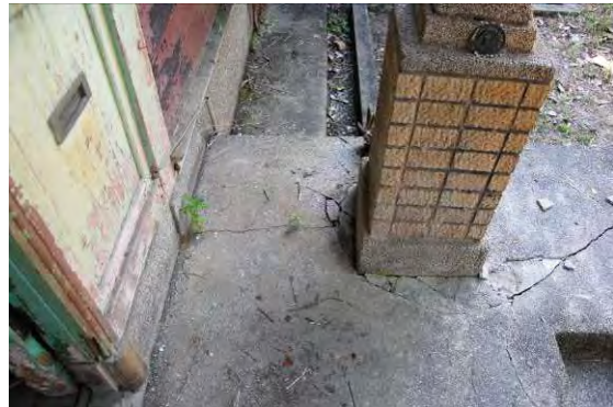
照片 7-2 洗石子地坪局部龜裂
