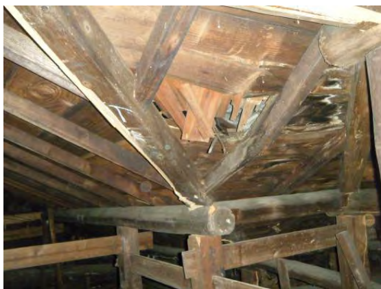
照片 4-19 屋面交界處滲漏痕跡
