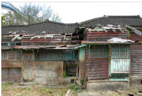
照片 4-28 屋瓦脫落，野地板破損
