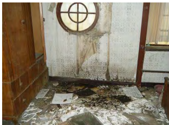
照片 4-8 因漏水潮濕的地板
