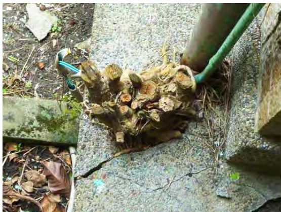
照片 4-5 著生於建築裂縫處的榕樹小苗，上方已刈除
