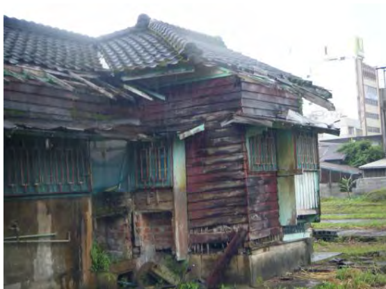
照片 4-23 檐口屋面嚴重毀損
