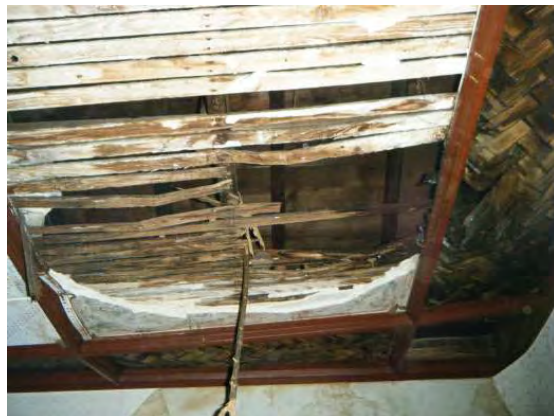
照片 4-24 屋頂破損造成反覆的雨水滲漏，使室內天花板受水分破壞嚴重
