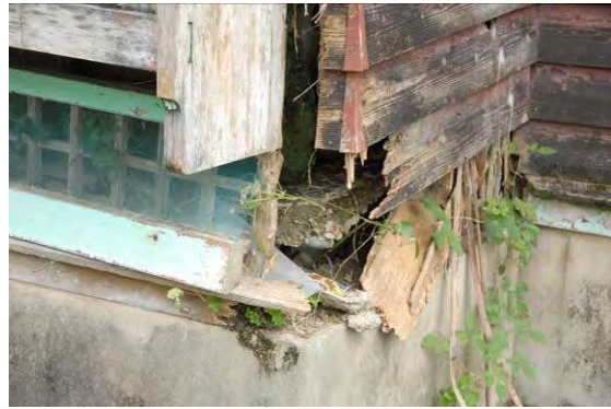
照片 7-6 雨淋板腐朽破損
