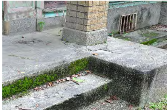
照片 4-33 洗石子基礎表面龜裂破損
