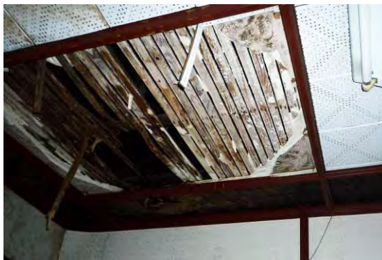
照片 7-16 洋式天花破損
