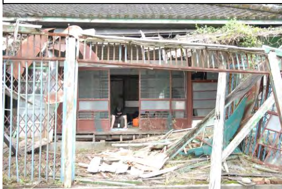
照片 4-36 緣側毀損嚴重
