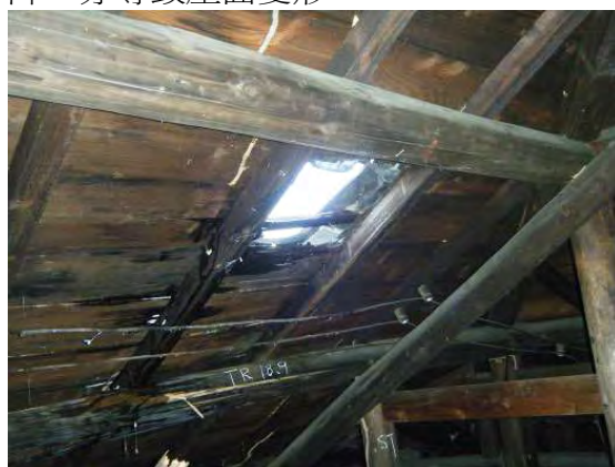
照片 4-22 屋頂破損而出現空洞，使構件直接暴露於天候劣化下
