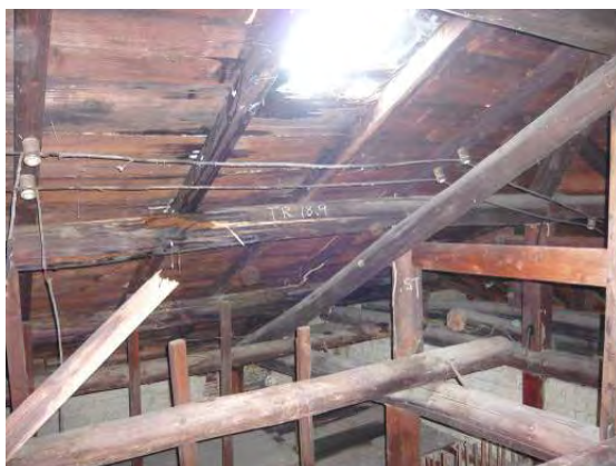
照片 4-11 屋頂破損
