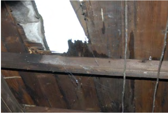
照片 7-17 屋面破損
