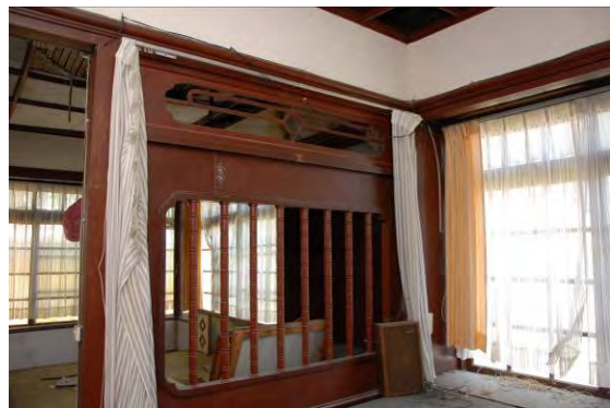
照片 7-4 木作潮氣破壞
