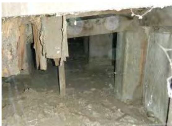
照片 4-7 床架上發現白蟻遮蔽管
