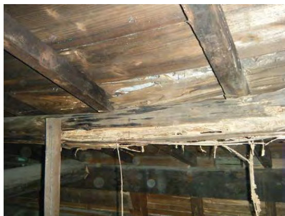
照片 4-20 屋桁受白蟻蛀蝕使承载力下降，亦導致屋面變形
