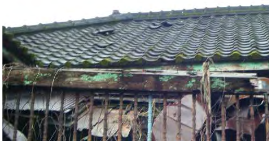
照片 4-21 屋瓦部分開掀損壞
