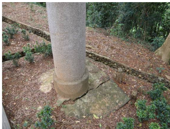
照片 7-12 基座局部破損
