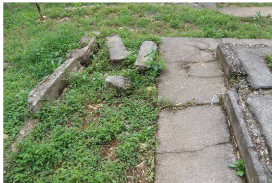
照片 7-2 基座局部破損
