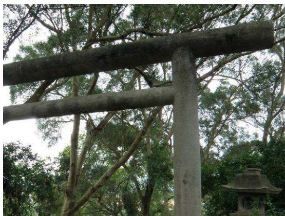
照片 7-11 第二鳥居表面局部汙損
