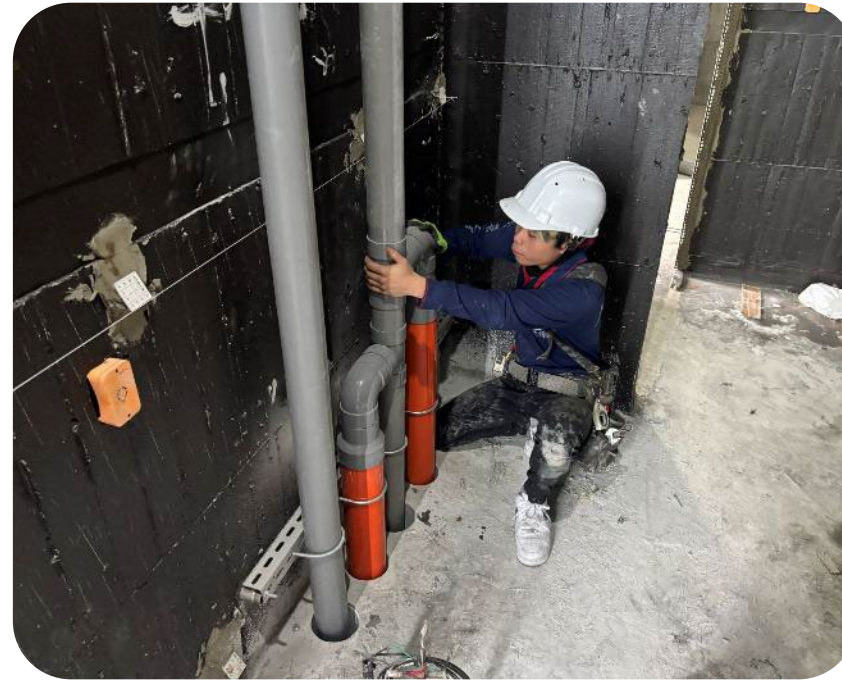
115/4/6-4F 管道間配管
