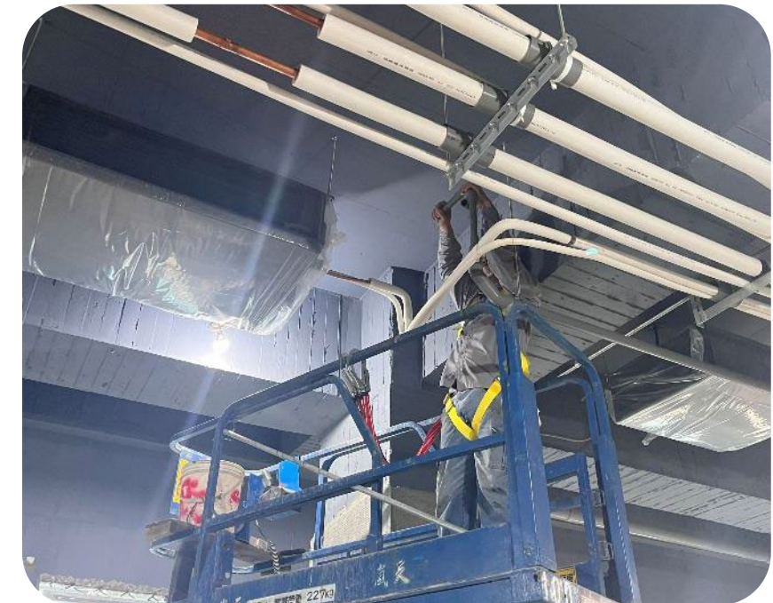
115/4/21-2F空調排水配管
