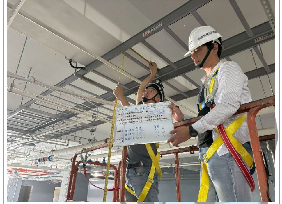
115.04.22 B1電力系統查驗(線槽)
