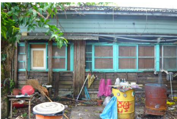
【圖 3-136】後棟西側的格子窗保留尚稱完整，僅部份毀損需檢修或抽換。
