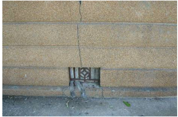
【圖 3-59】特殊造型的勒腳牆與被填補的通氣口，推側原始應為架高木地板，後來全面以混凝土填補形成實體台座。
