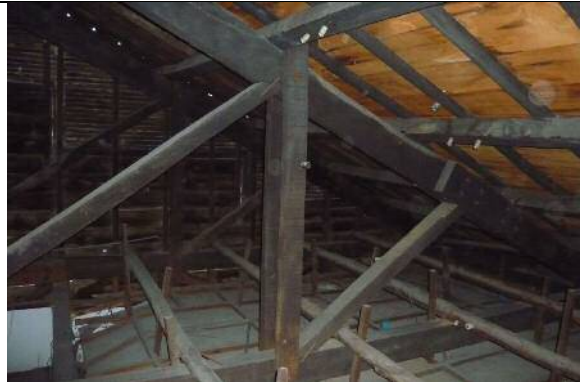
【圖 3-91】未有碳化黑污的構件一部份是原始構件，一部份則是後來修復抽換的新構件。屋面板、椽子等皆已更換為新的木料，總體狀況良好。但屋瓦以金屬鋼浪板取代
