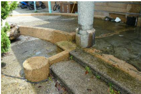
圖 4-62：前棟入口處地板狀況
