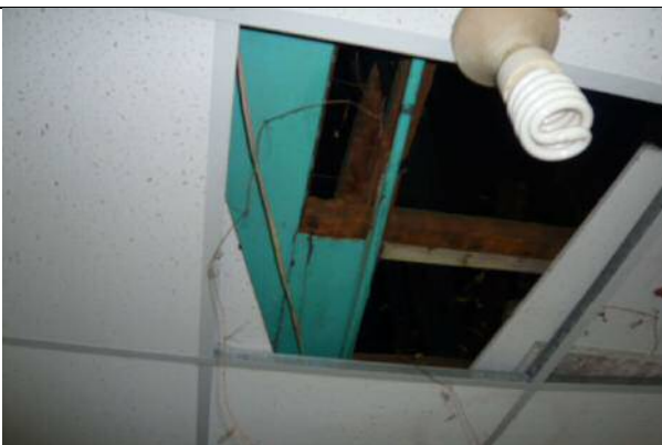
【圖 3-104】原木質天花板被覆蓋在新的明架天花內。
