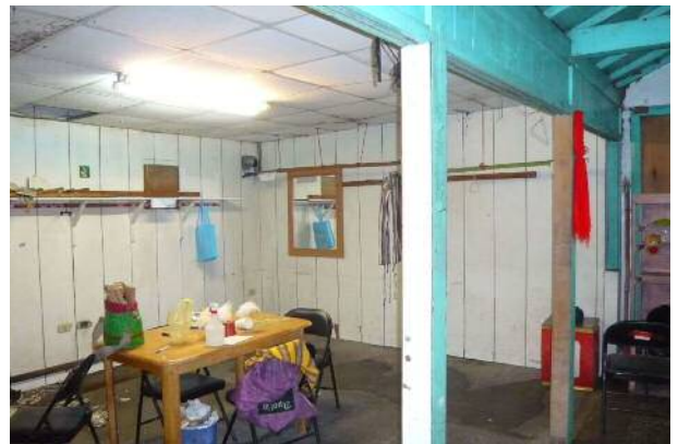
【圖 3-141】中央連廊南面格子窗約一半已遭拆除改為違建鐵皮屋，無法修復。未來這部份將重作為落地格子門，讓廊道空間與外面的中庭花園保持更好的視覺穿透性。
