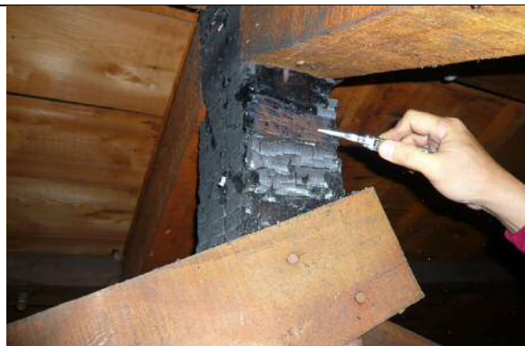
【圖 3-93】表面碳化約 0.5cm 厚，未影響到構件木質。
