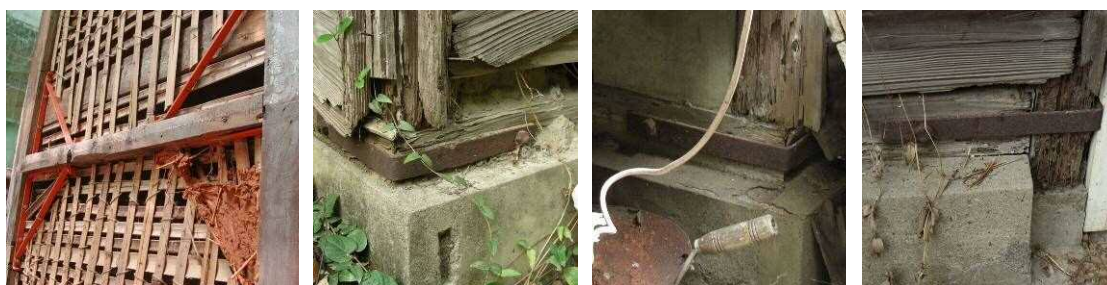
左：彰化武德殿附屬建築 / 右：1935 年地震後日式木造官舍補強實例（台中市歷史建築潭子國小校舍）
