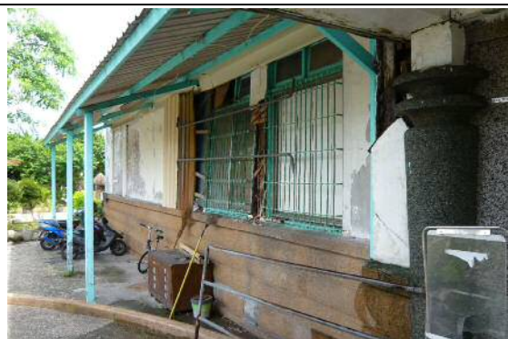
(圖 6-14)勒腳牆多處表面層脫落情形亦須予以復原
