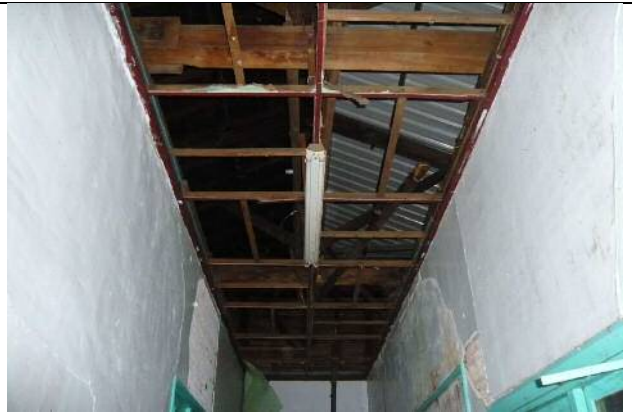
【圖 3-97】中央走廊東面的屋面板與椽子尚保留，西面則拆除以鐵皮浪板取代，至於立柱與牆體則大致保持完整
