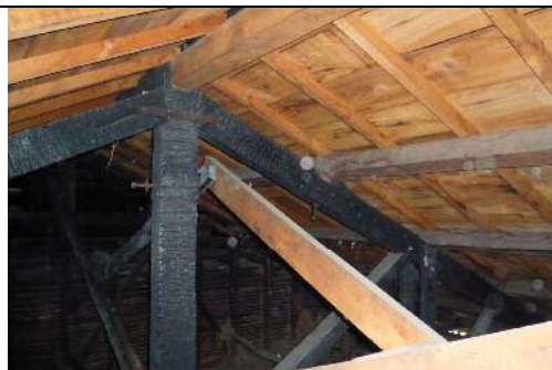
圖 3-53 部份屋架與屋桁表面有許多明顯的火損碳化痕跡。
