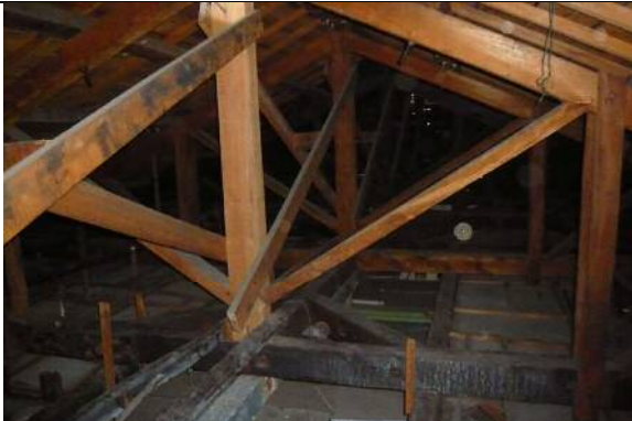
【圖 3-90】左翼的 9 組桁架、火打與繫帶等屋架大約半數有表面碳化黑污的火損破壞。
