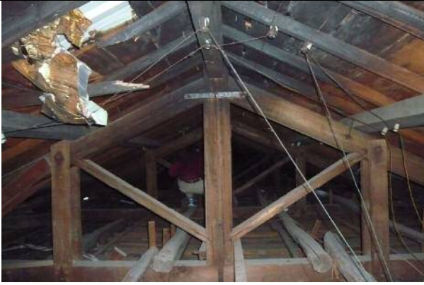
【圖 3-100】整體長條型屋架總共由 23 組桁架所組成，屋架現況除少數有損壞的情形外，絕大部份的狀況都保持非常良好。
