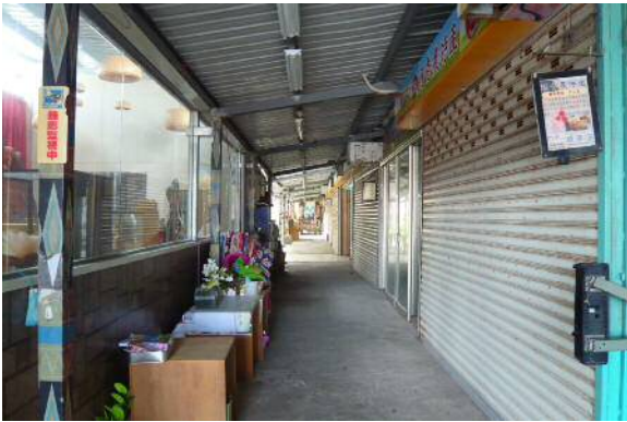
【圖 3-80】C-01：原為連接各個病房的長排簷廊，牆面、簷廊與立柱已完全遭到破壞拆除，現再往外搭建鐵皮走廊。
