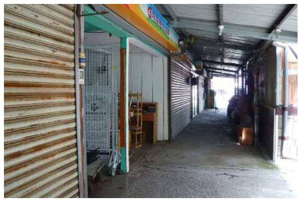
【圖 3-63】後棟的東側牆面與簷廊已遭破壞佚失。
