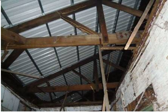
【圖 3-88】右翼的桁架、火打與繫帶等屋架現況良好，但屋面板、椽子、天花板等皆已遭拆除，並以槽鐵與金屬鋼浪板取代。
