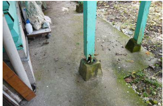
圖 4-63：前棟前廊處地板狀況
