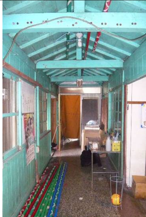
【圖 3-107】北面牆體與立柱尚保留原貌，南側牆體則大部份已遭拆除，但立柱依然存在。
