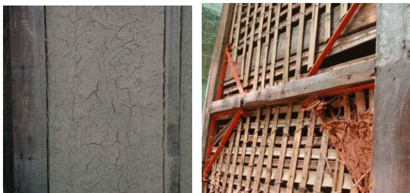
泥料乾縮木框出現縫隙（左）以及木柱與貫木節點以鐵件補強
