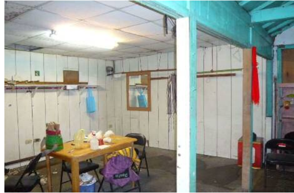
【圖 3-85】B-01：南側則已拆除毀損，並搭建鐵皮屋。
