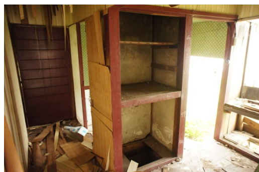
照片 4-3.11 空間 07 押入真壁構造
