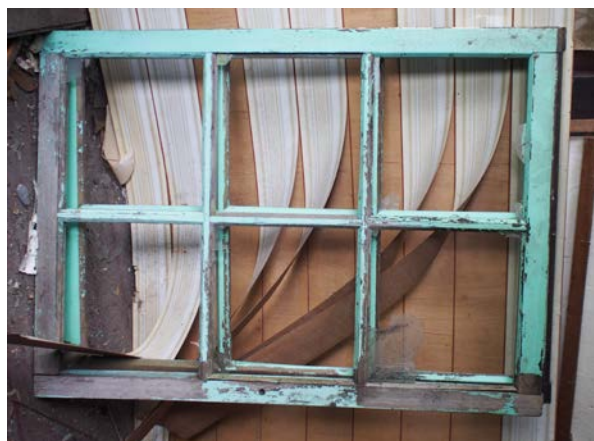
照片 4-2.37 W3 建具窗扇現況照片
