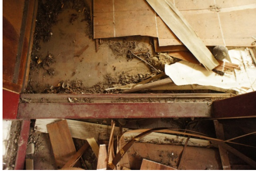
照片 4-3.3 空間 06 木地板上覆蓋夾板
