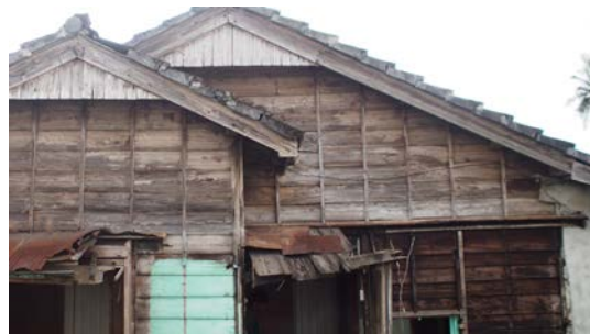
照片 5-2.11 雨庇現況損壞情形
