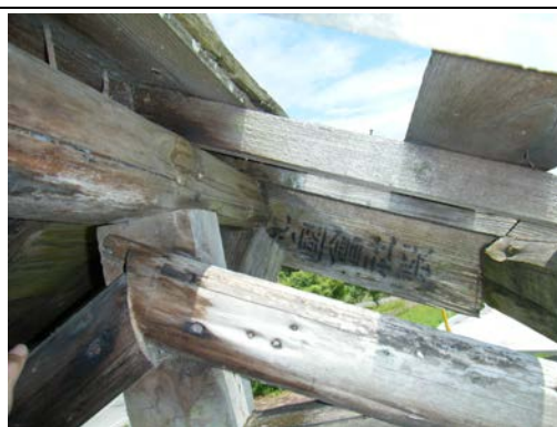
照片 5-2.29 破風板破損情形
