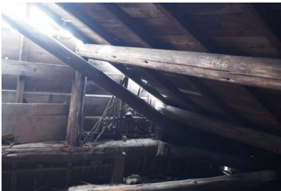
照片 5-2.22 屋組 T1 屋面板與母屋白化腐朽
