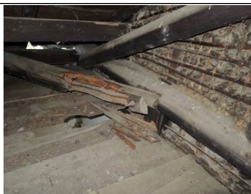
照片 5-2.77 火打樑嚴重腐朽。
