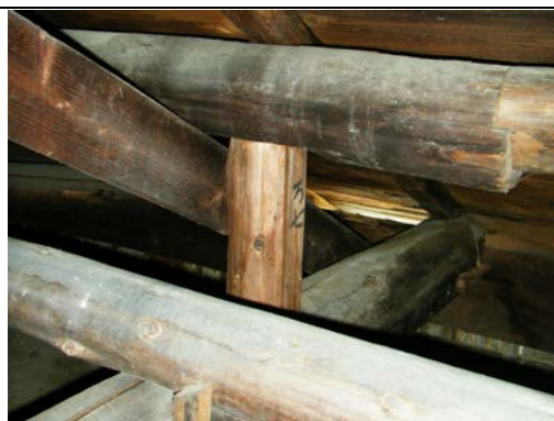
照片 5-2.37 V7 立柱與水平樑劈裂情形
