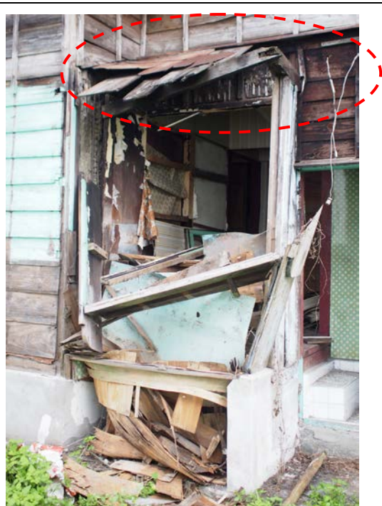
照片 5-2.13 銅板瓦現況
