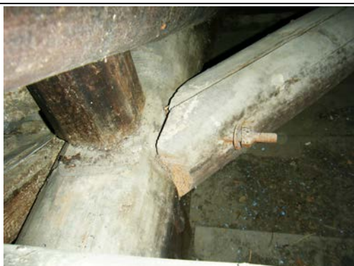
照片 5-2.52 火打樑金屬構件生鏽
