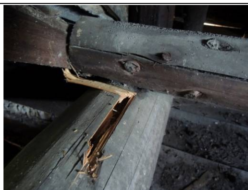
照片 5-2.55 H2 小屋樑乾木白蟻危害。
