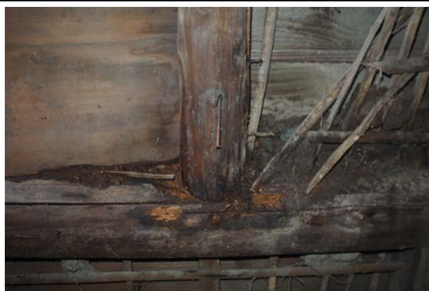
照片 5-2.25. V5&H2 損壞情形
