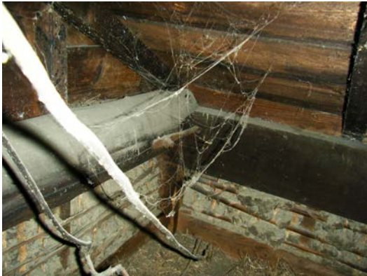
照片 5-2.68 屋樑與軒桁接合情形-1
