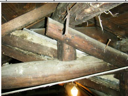
照片 5-2.42 棟木劈裂情形
