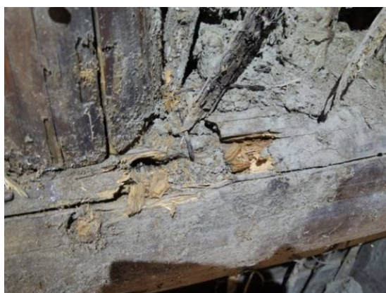
照片 5-2.32 H2 小屋樑褐腐、軟腐及蟻道危害。
