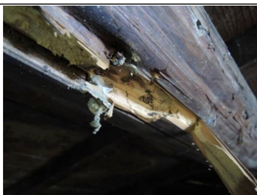
照片 5-2.72 母屋(Y2)乾木白蟻危害。
