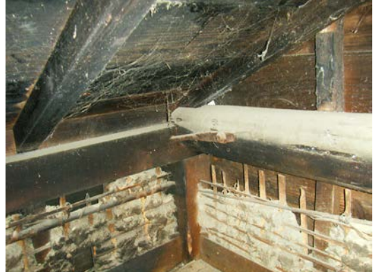
照片 5-2.69 屋樑與軒桁接合情形-2
