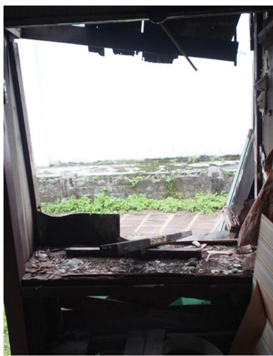
照片 5-2.108 現況櫥櫃外加出窗情形
