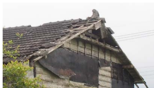
照片 5-2.18 背向立面屋脊屋瓦破損情形
