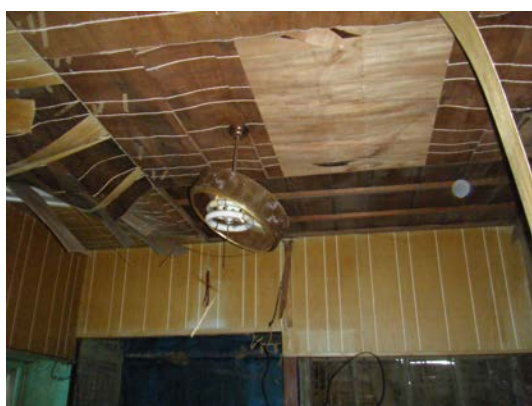
照片 5-2.90 天花板受潮夾板變形
