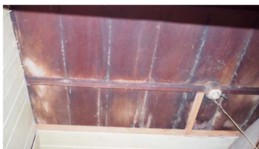
照片 5-2.86 竿緣天花板情形
