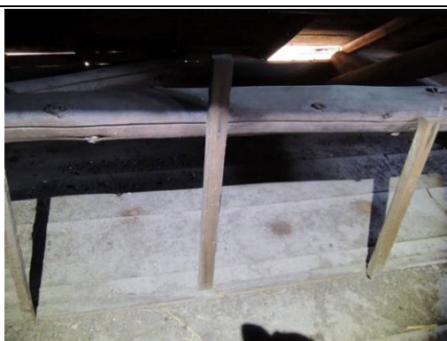
照片 5-2.76 地樑開裂現況。
