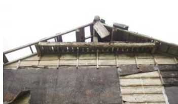
照片 7-3.15 現況屋面損壞照片
