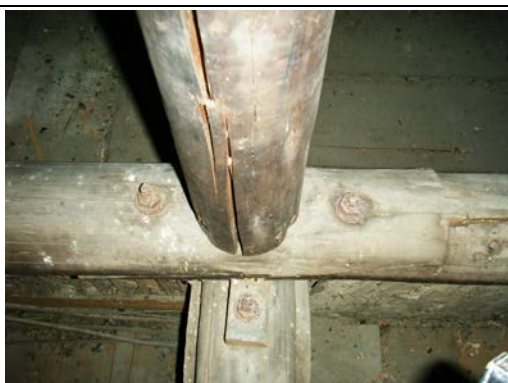
照片 5-2.48 短柱 V2 多處劈裂與下方繼手
