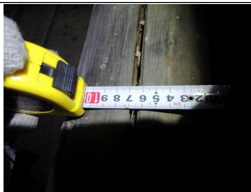
照片 5-2.53 小屋樑開裂約 10 mm。
