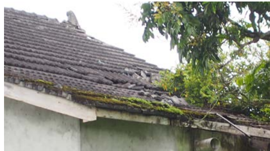
照片 5-2.19 增建區域屋頂受損情形
