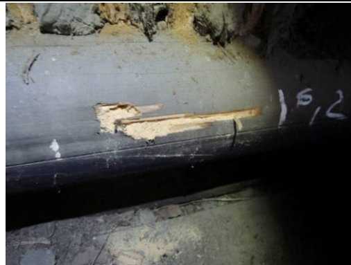
照片 5-2.65 小屋樑表面蟲蟲危害。
