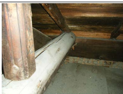
照片 5-2.39 V6 立柱與 H1 水平樑劈裂情形
