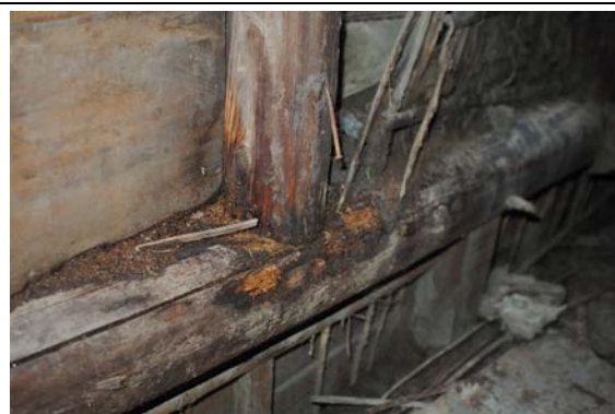
照片 5-1.3 構件腐朽及乾木白蟻危害
