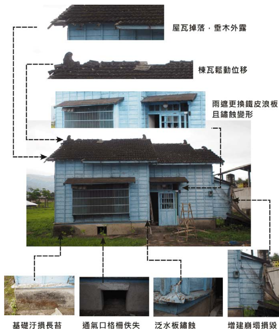
圖 5-2.5 正向立面損壞標示圖 本研究整理
