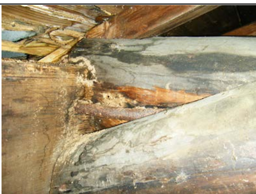
照片 5-2.38 水平樑與軒桁蛀蝕情形
