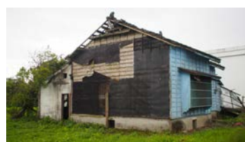
照片 7-3.14 現況北側立面損壞照片
