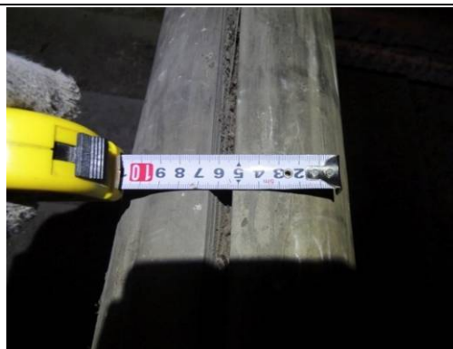
照片 5-2.75 地樑開裂 12 mm
