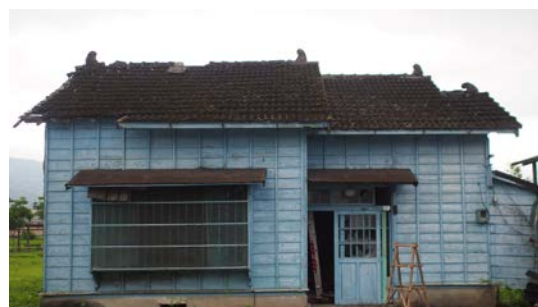
照片 5-2.16 立面屋瓦破損情形
