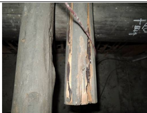
照片 5-2.79 地樑端部乾木白蟻蟻道危害。
