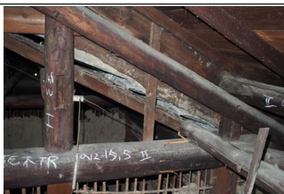
照片 5-2.57 遭生物性危害之現況-2。
