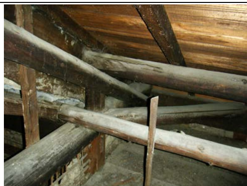
照片 5-2.51 火打樑與 B7 母屋劈裂情形
