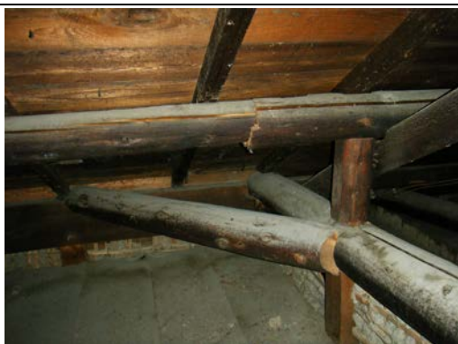
照片 5-2.44 水平樑與 B6 母屋劈裂情形
