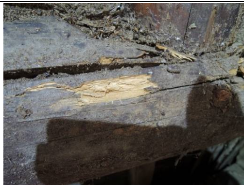
照片 5-2.31 H1 小屋樑軟腐裂化。
