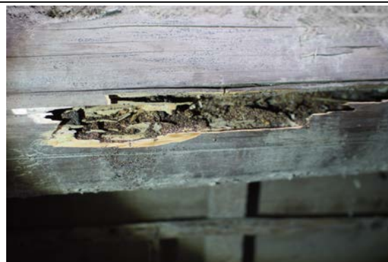
照片 5-1.5 蟻道、乾木白蟻危害
