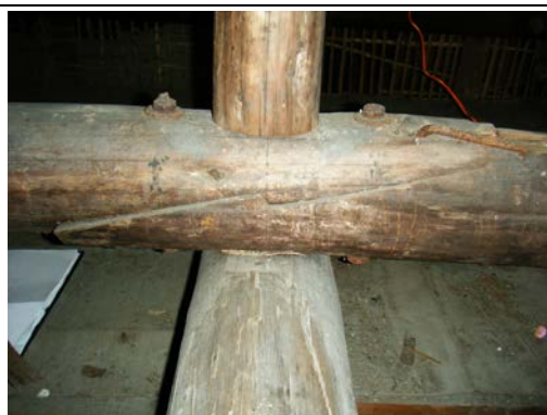
照片 5-2.35 小屋投掛樑繼手搭接、鐵件生鏽
