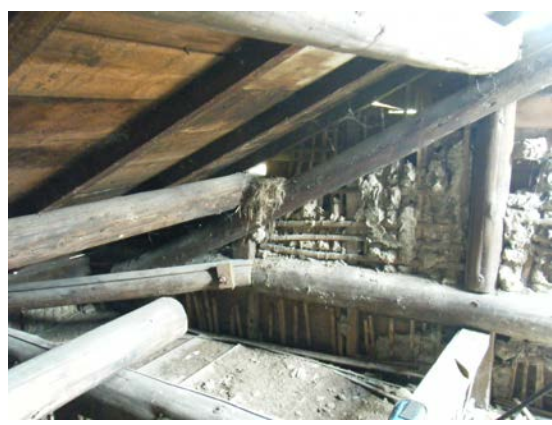
照片 5-2.21 屋組 T1 壁土崩落情形
