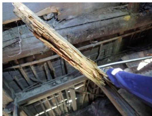
照片 5-2.33 H1 小屋樑軟腐部分可輕鬆剝出
