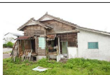
照片 7-3.17 現況南側立面損壞照片
