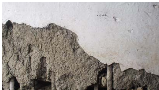
照片 5-2.84 壁土剝落情形
