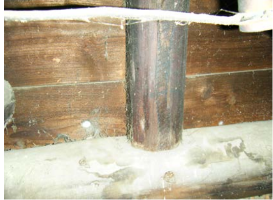
照片 5-2.67 水平屋樑水痕
