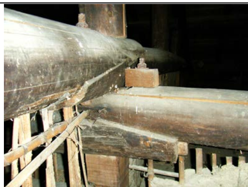
照片 5-2.49 水平樑劈裂與兩繼手搭接情形
