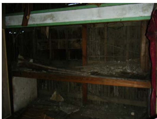
照片 5-2.94 押入空間背牆與床板損壞情形
