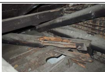
照片 7-3.18 現況屋架損壞照片
