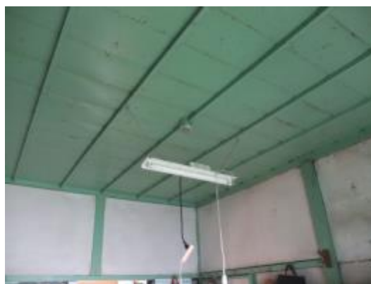
照片 4-2.120 B2 戶建築物居間天井現況照片
