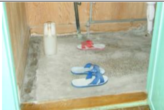
照片 4-3.66 空間 B-2-07 便所磨石子地坪現況
