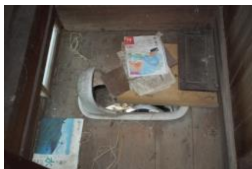
照片 4-3.6 空間 A-1-04 便所木地板現況
