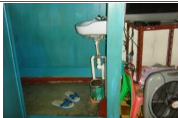
照片 4-3.65 空間 B-1-07 便所磨石子地坪現況
