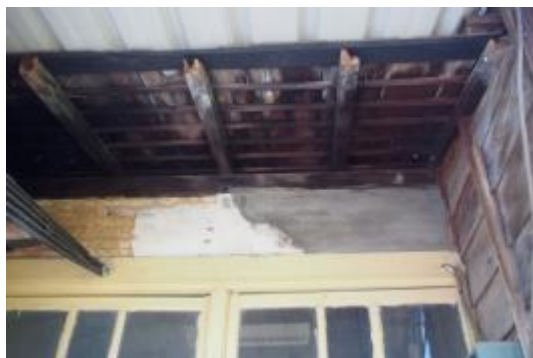
照片 6-3.3 A 幢入口處雨庇損壞情形
