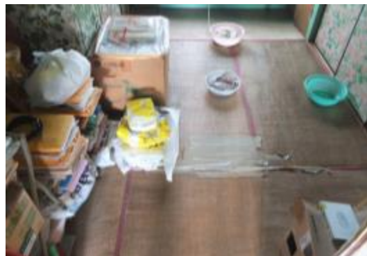
照片 6-3.18 榻榻米地坪現況
