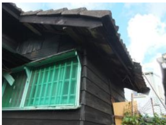
照片 6-3.5 破風現況照片
