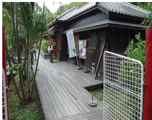
【照片 2-5-52】位置 10：服務中心前的木質地板起翹，考量安全性應加以修繕維護
