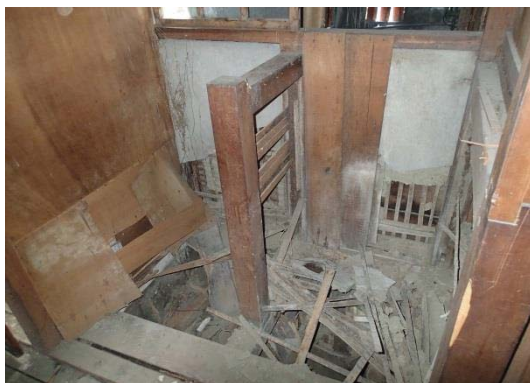
【照片 2-4-134】原為廁所，現況已損毀
