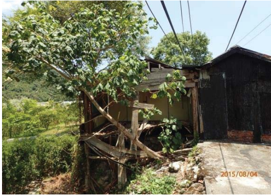
【照片 2-5-5】位置 5：已坍塌一半的建築
