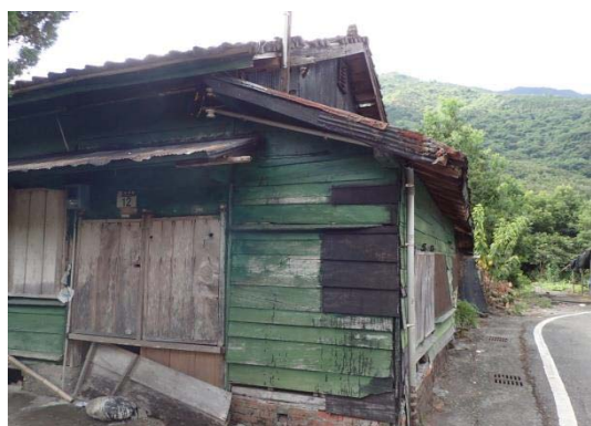
【照片 2-5-63】位置 5：屋頂加裝鋼浪板且牆面有明顯修補痕跡
