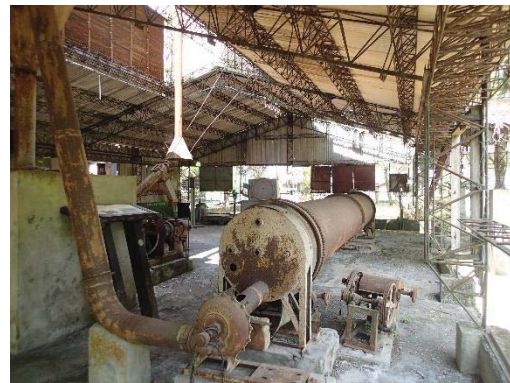
【照片 5-1-149】製礮設備嚴重生鏽
