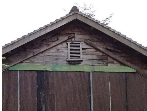
【照片 5-1-77】雨淋板劣化
