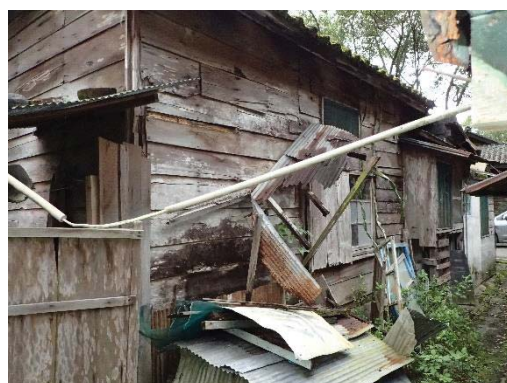
【照片 5-1-107】雨淋板工法粗糙
