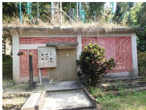
【照片 5-1-151】機房在林場懷舊館後方，磚砌平房屋頂寄生大量雜草，上方設置大量基地台
