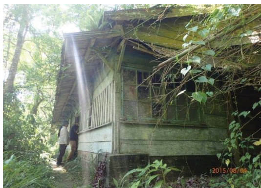
【照片 2-5-79】位置 3：康樂新村的木造連棟宿舍被植物覆蓋，且牆面都生長了青苔，門窗、玻璃等有損壞
