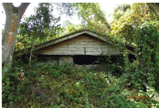
【照片 2-5-73】位置 1：受到土石流破壞而塌陷的幼稚園校舍
