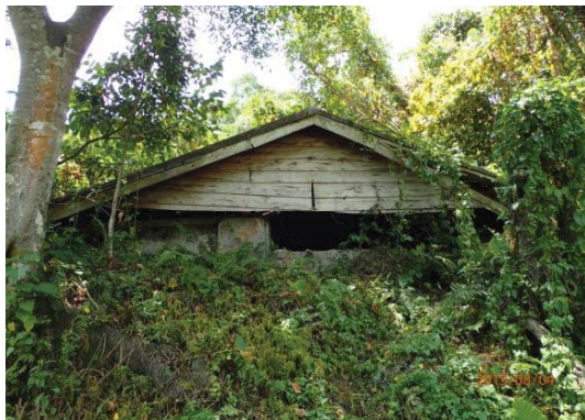
【照片 2-5-8】位置 8：幼稚園因土石流而損壞
