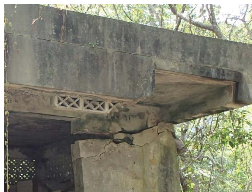
【照片 5-1-145】牆體明顯開裂
