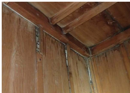
【照片 2-4-87】內牆原本為木摺泥牆(林森路 91 號)
