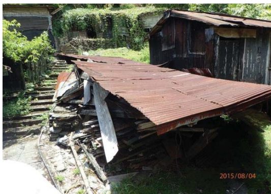
【照片 2-5-54】位置 2：居民堆置的雜物
