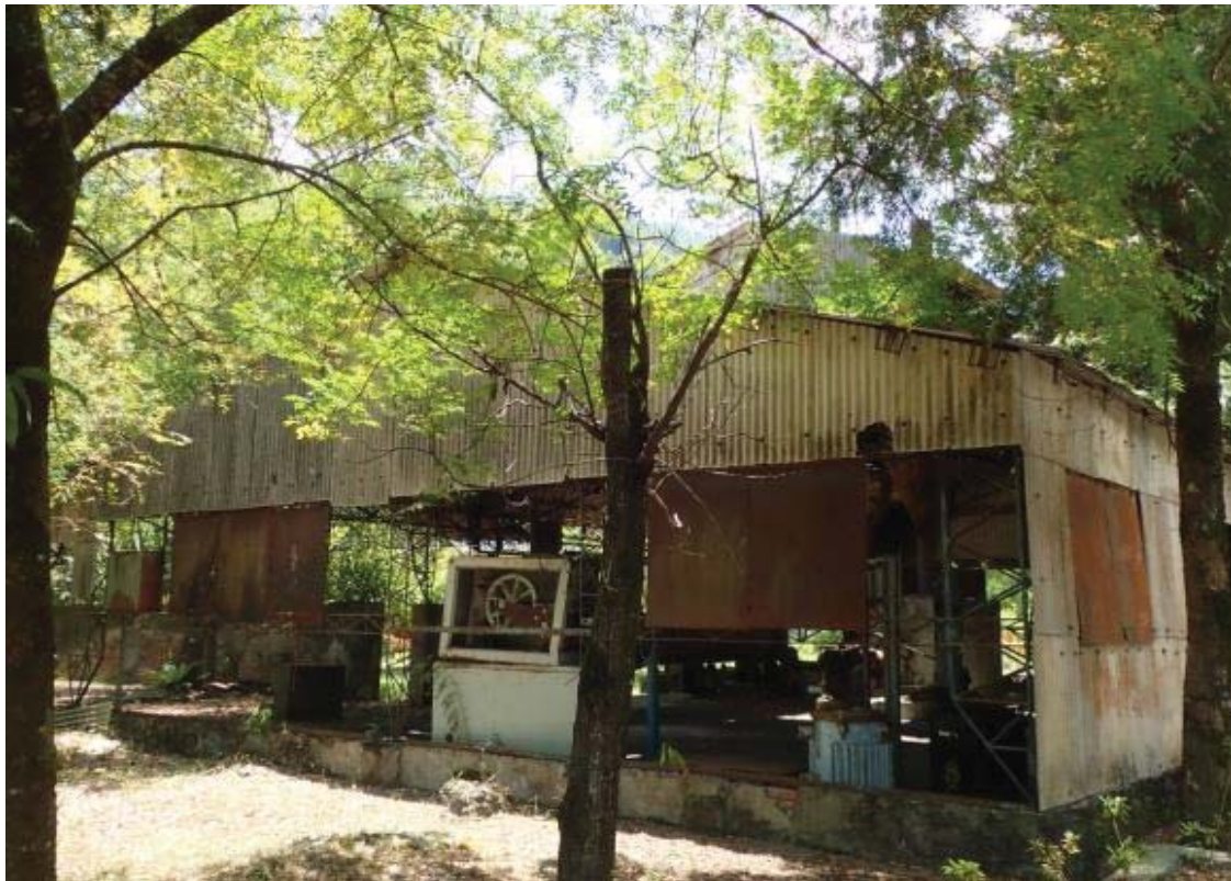
【照片 2-5-7】位置 7：原子礮工廠廠房老舊
