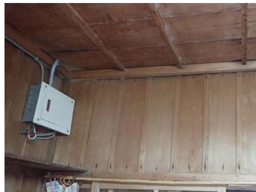
【照片 5-1-58】線路總開關設置在最重要之「座敷」空間
