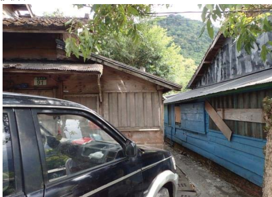
【照片 2-5-12】位置 12：員工宿舍多處臨時補強痕跡
