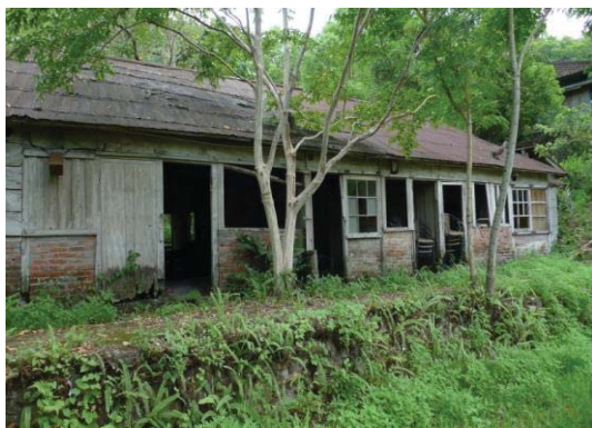
【照片 2-5-21】位置 7：木造宿舍破損嚴重
