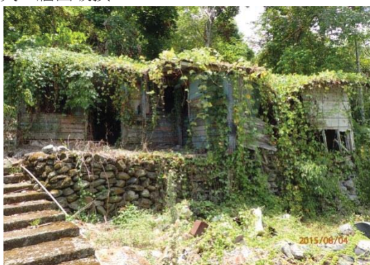
【照片 2-5-87】位置 11：溪邊木造宿舍被植被覆蓋，窗戶缺失
