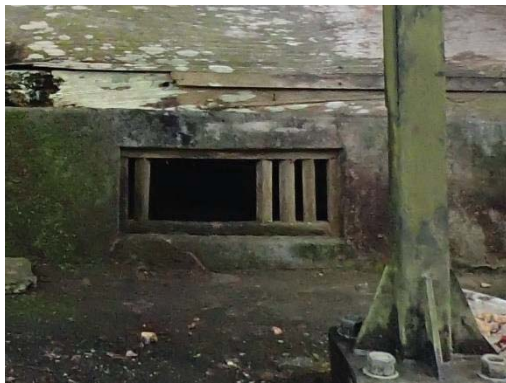
【照片 5-1-29】木隔柵腐朽與部分缺失
