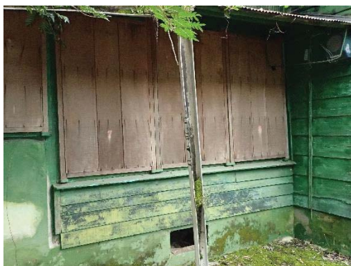
【照片 5-1-76】雨淋板表面油漆
