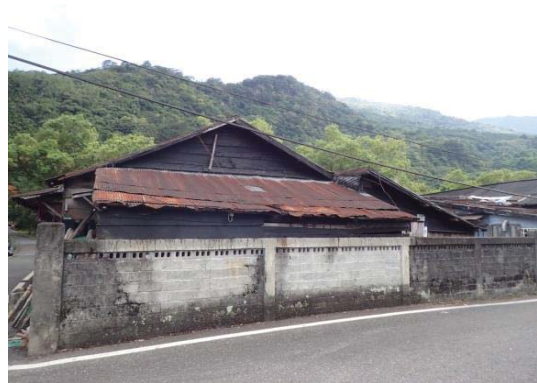
【照片 2-5-2】位置 2：屋頂和牆面破損
