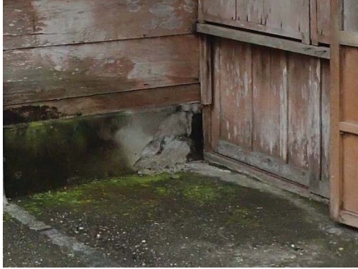
【照片 5-1-27】連續基礎粉刷層剝落
