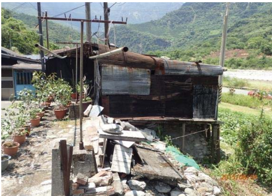
【照片 2-5-4】位置 4：河堤邊加建鐵皮，鐵皮已鏽蝕
