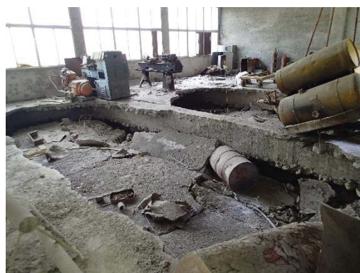
【照片 5-1-143】建築物因底層木屑長時間腐爛，地坪已嚴重塌陷
