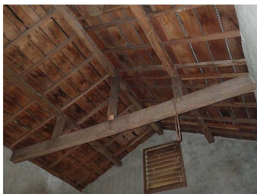
【照片 5-1-9】未整修之倉庫屋架發現蟻道
