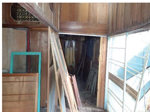
【照片 5-1-60】「緣側」構件傾斜
