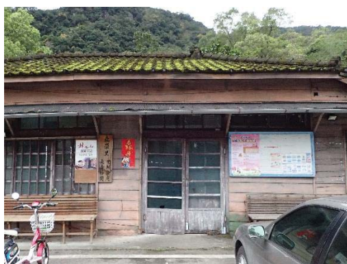
【照片 5-1-114】水泥瓦表面寄生大量青苔
