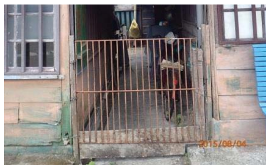
【照片 2-5-68】位置 2：宿舍與宿舍間的通道被隔柵阻擋做為私人空間
