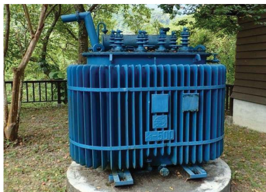
【照片 2-4-115】修理工廠前展示的三相變壓器
