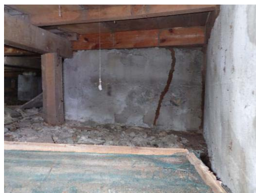
【照片 5-1-10】未整修之日式宿舍(林森路 42 號)基礎發現蟻道
