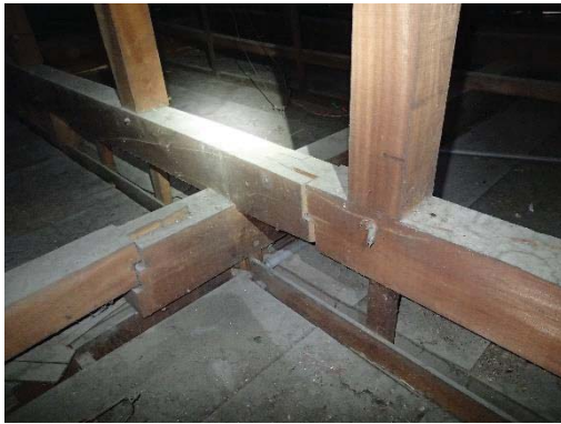
【照片 5-1-25】「敷樑」樁接處正好在「吊束」的上方，使「吊束」失去作用
