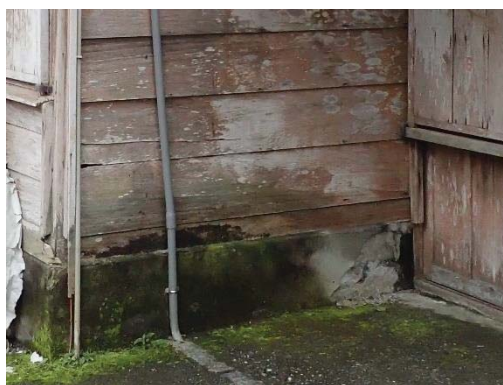
【照片 5-1-38】雨淋板龜裂
