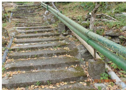
【照片 2-5-55】位置 3：康樂新村的遊客動線上，多處水管外露有礙觀瞻
