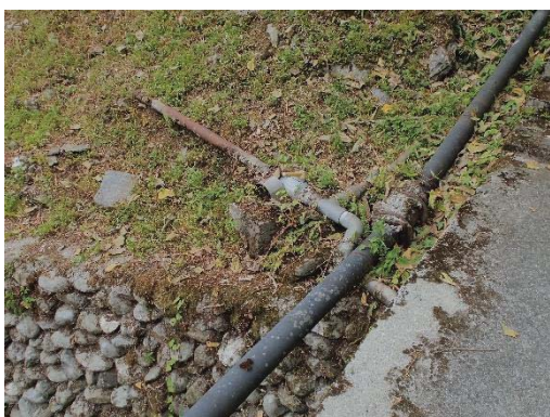
【照片 5-1-160】外露的消防管線
