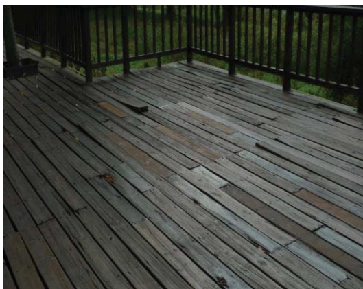
【照片 2-5-51】位置 9：木雕一、二館旁之木質地板起翹，考量安全性應加以修繕維護
