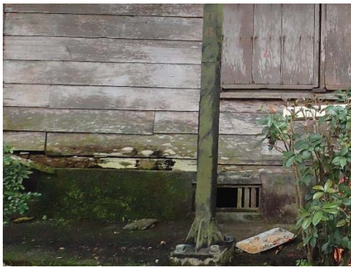
【照片 5-1-23】「土台」構件受潮腐朽
