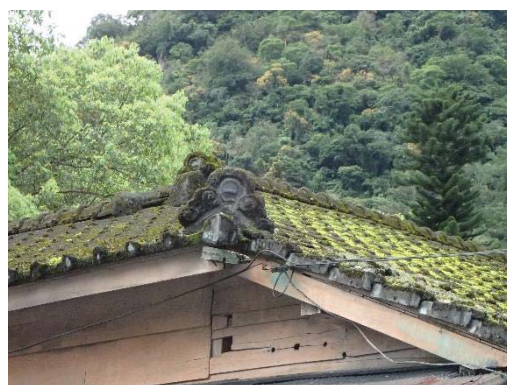
【照片 5-1-115】水泥瓦表面寄生大量青苔
