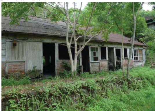
【照片 2-5-85】位置 9：連棟木造宿舍，門窗缺失，牆面破損
