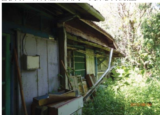
【照片 2-5-84】位置 8：木造宿舍水管掉落，周邊堆滿雜物
