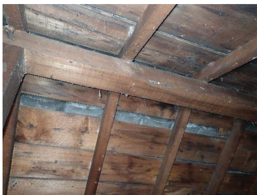
【照片 5-1-49】屋面板鋪法較為簡易，縫隙過大
