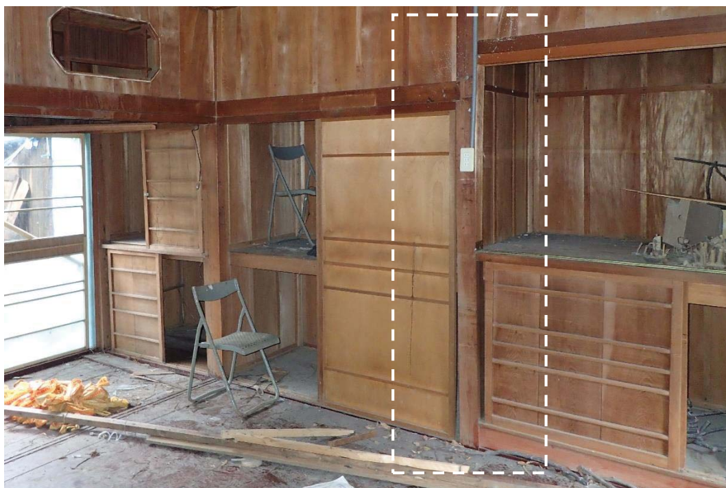
【照片 5-1-59】木構件傾斜，門扇無法與柱子密合
