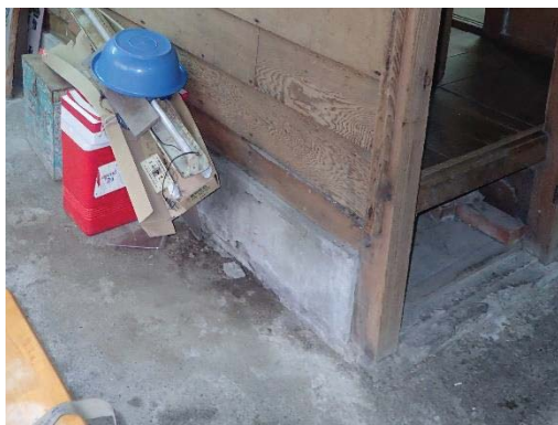
【照片 5-1-35】水切板缺失
