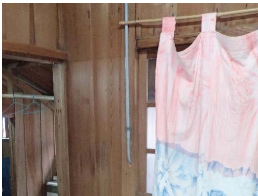
【照片 5-1-57】既有管線突兀
