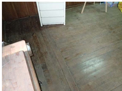
【照片 5-1-95】室內水平「敷居」遭拆除
