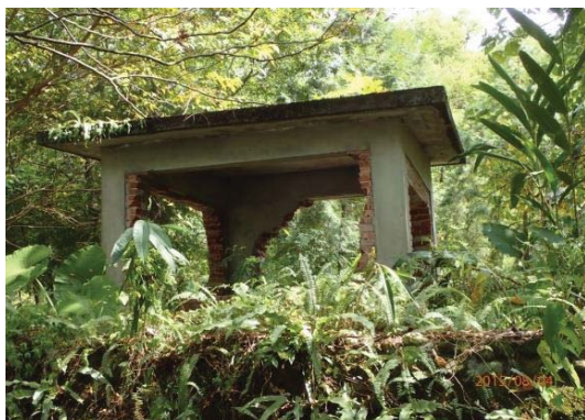
【照片 2-5-10】位置 10：林安路旁的磚造建築損毀
