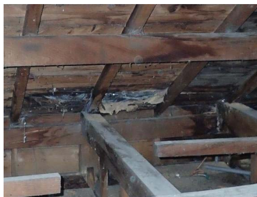
【照片 5-1-50】木構件受潮腐朽
