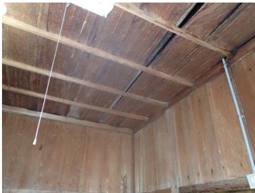
【照片 5-1-43】天花板破損
