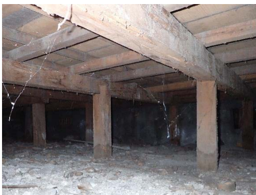
【照片 5-1-64】獨立木基礎直接落在卵石地基上，下側明顯受潮
