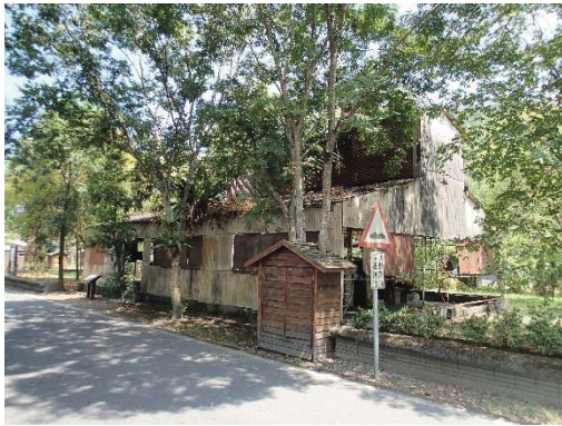
【照片 5-1-146】外覆的石綿纖維瓦破損
