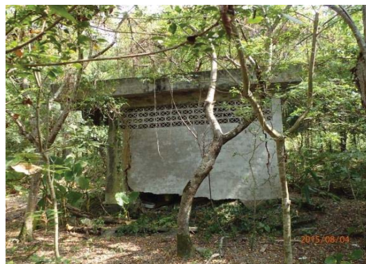
【照片 2-5-11】位置 11：廁所損毀無人修繕
