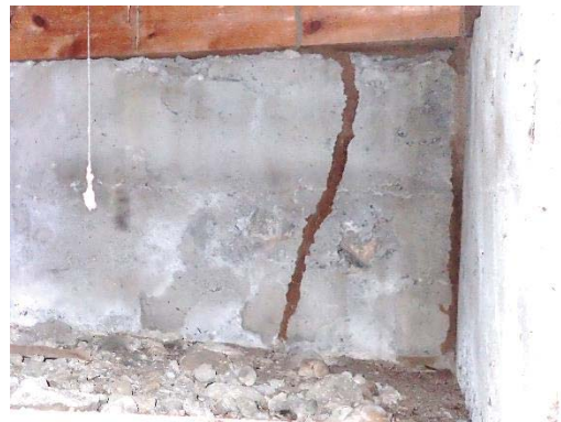
【照片 5-1-69】基礎發現蟻道
