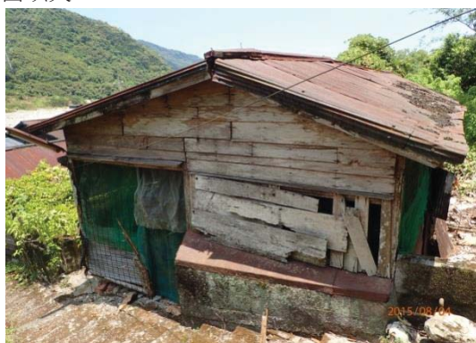
【照片 2-5-88】位置 11：木造建築物門窗缺失，以紗網遮蔽，窗戶破損以木板補丁
