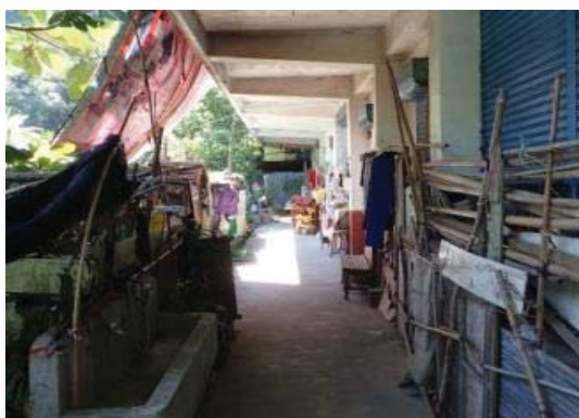
【照片 2-5-56】位置 4：舊教室走廊堆置雜物
