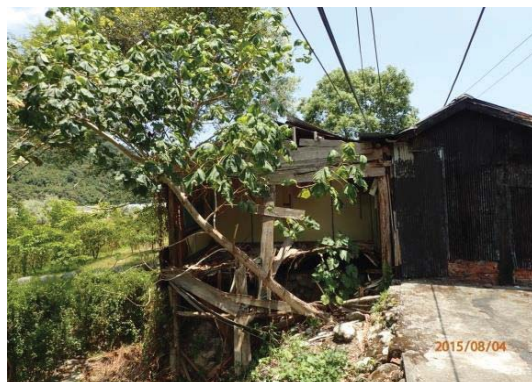
【照片 2-5-82】位置 6：木造架高建物受災害影響損壞，部分牆面缺失，支架損壞嚴重
