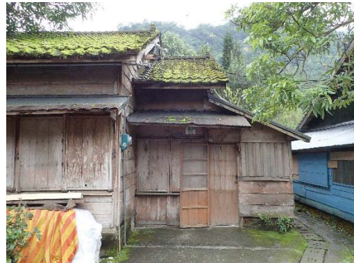
【照片 5-1-52】水泥瓦保存狀況不佳，且寄生青苔
