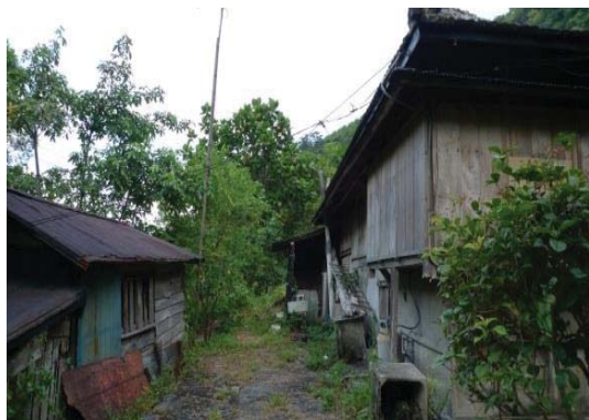
【照片 2-5-81】位置 5：火災紀念館旁之木造宿舍，雨淋板破損，部分牆面以鐵皮補強
