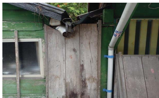
【照片 2-5-67】位置 1：宿舍與宿舍間的通道被被封閉
