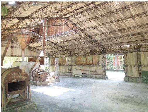
【照片 5-1-148】鋼構骨架嚴重生鏽
