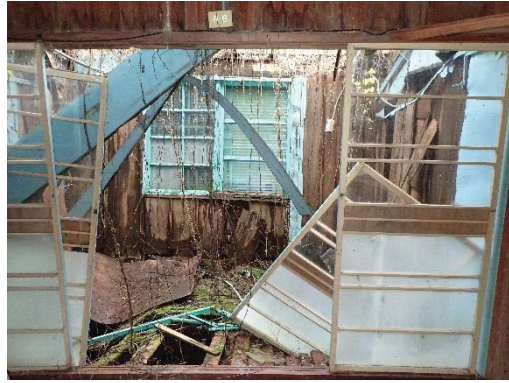
【照片 5-1-63】原有構件因後期增建坍塌而受潮腐朽
