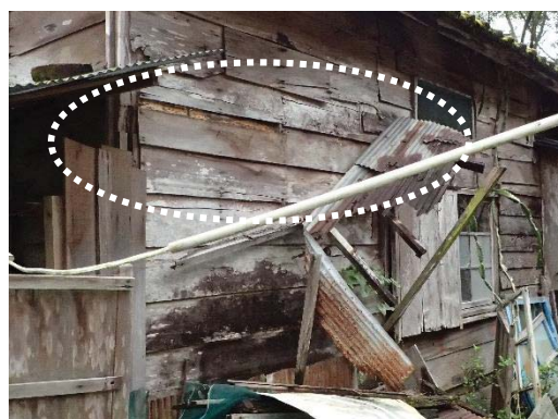
【照片 5-1-117】原有雨庇因增改建而拆除
