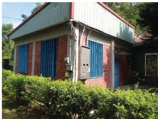
【照片 5-1-150】萬榮工作站右側磚砌平房漏水，目前加蓋鐵皮屋保護
