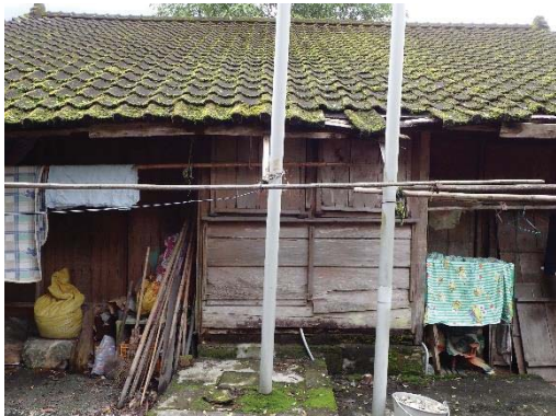
【照片 5-1-51】水泥瓦保存狀況不佳，且寄生青苔
