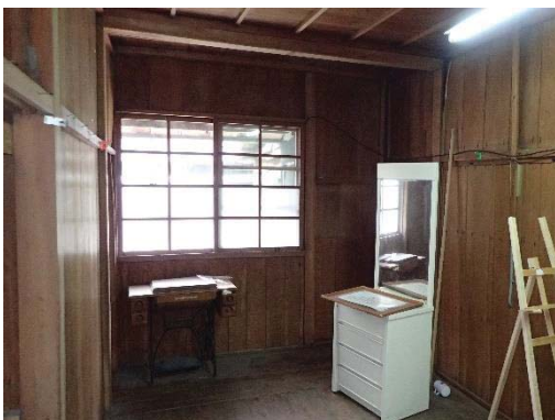
【照片 5-1-94】室內水平「鴨居」遭拆除
