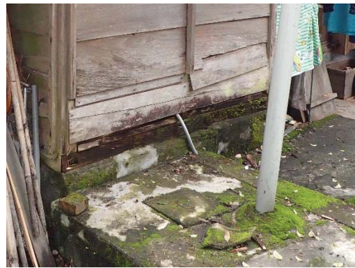
【照片 5-1-24】「土台」構件受潮腐朽
