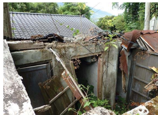
【照片 2-5-13】位置 13：修理工廠南方廢棄的廁所
